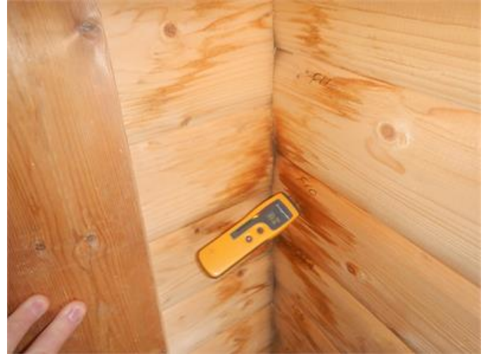
Fuktpåverkan i ytterhörn skidförråd.
