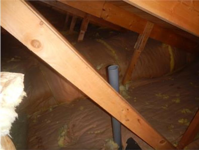
Avloppsventilation som avslutar på vindsutrymmet.
